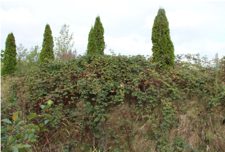
Figuur 15 Opslag van kleine boompjes en struweel, zoals deze bramen, zorgt plaatselijk op de dijkes voor dichtgroei. Bramen zijn op zich waardevol voor wilde bijen als voedselbron en nestelplek (in holle takjes), maar in dit geval weegt het belang van de dijkes als nestelplaats zwaarder. Bramen zijn in de omgeving volop aanwezig, terwijl dit niet geldt voor zulke dijkes.
